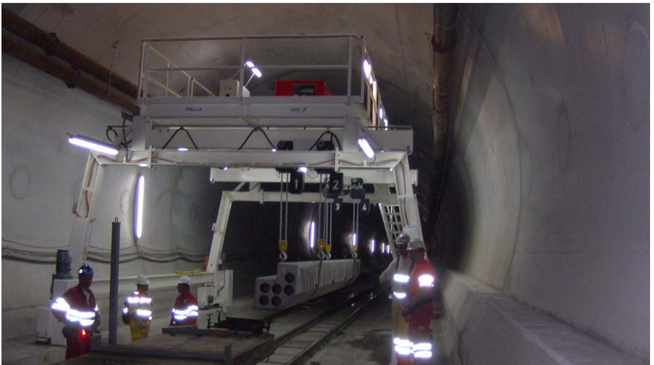
Gesamtanlage in Betrieb
