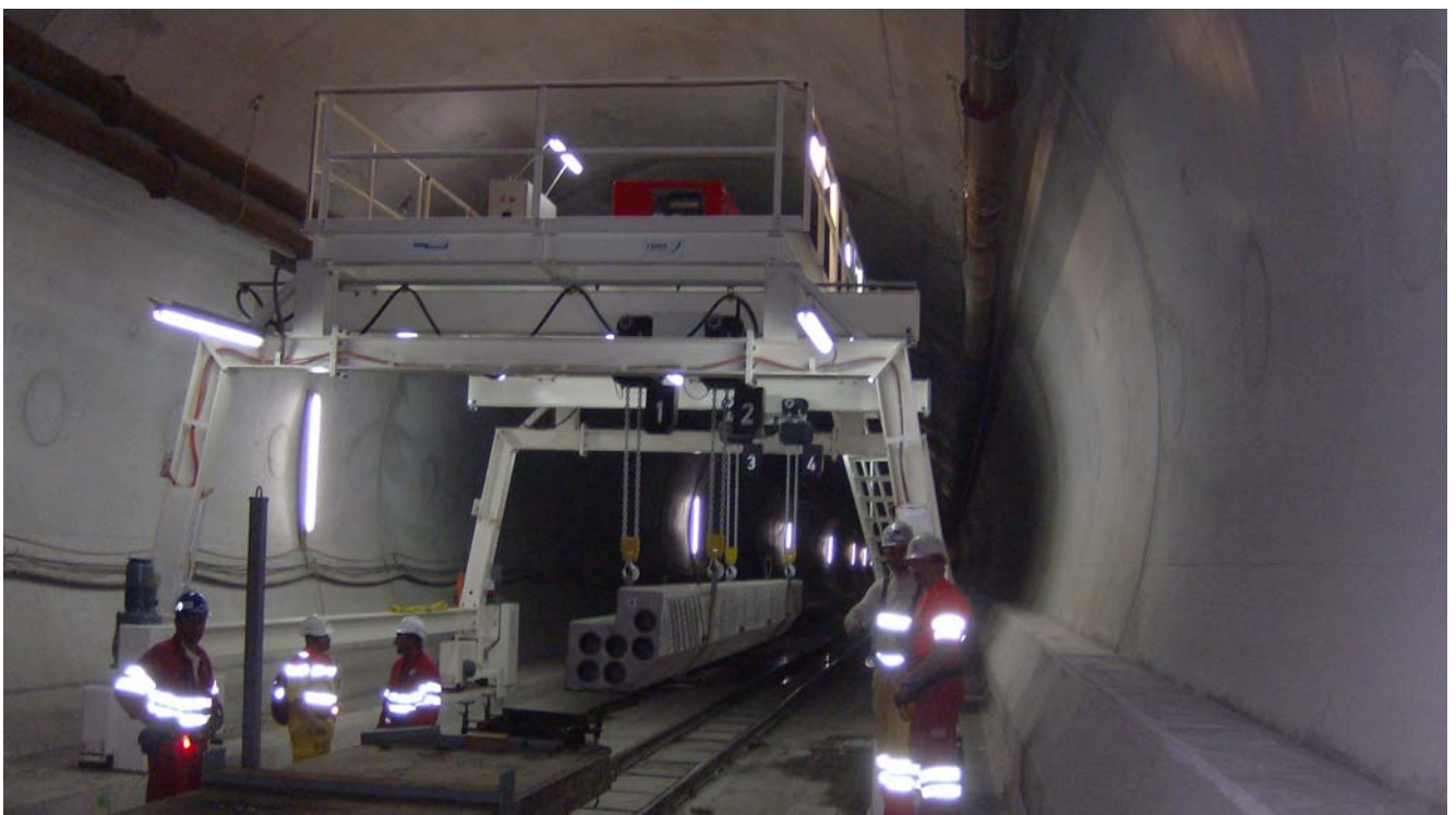
Gesamtanlage in Betrieb
