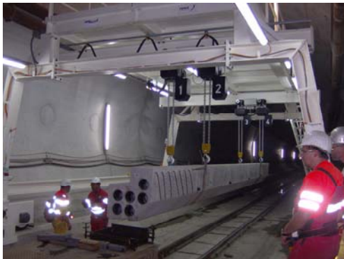
Anlage im Einsatz
