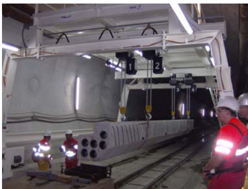
Anlage im Einsatz
