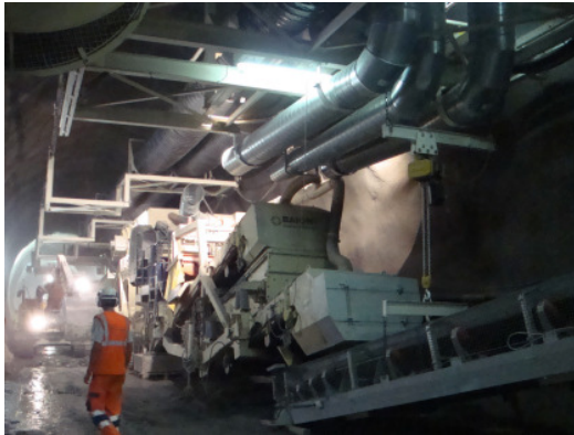
Schnittstelle zum Backenbrecher und ausgefahrene Ventilationsbühne
