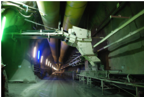
Querband zur Übergabe des Ausbruchmaterials der Oströhre auf das Streckenband in der Weströhre
