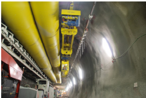
Monorail zur direkten Versorgung des Vortriebs
