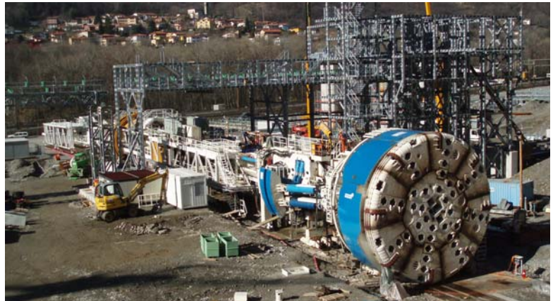
Nachlaufinstallation bereit für das Anfahren
