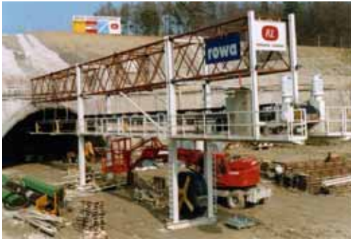
Streckenband-Förderanlage vor dem Portal
