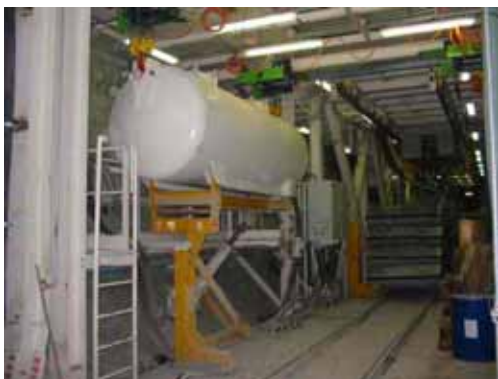
Trockenmörtelumschlag und Zwischenspeicher für Sohlübbinghinterfüllung
