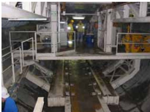
Tübbingmagazin mit Materialumschlagstelle
