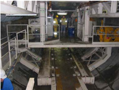
Tübbingmagazin mit Materialumschlagstelle
