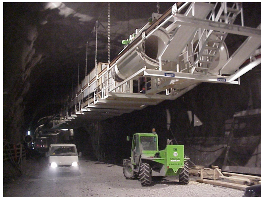
Heck der Vortriebsinstallation mit Luttenspeicher für die Frischluft- und die Sprenggasabsaugung in der Startphase
