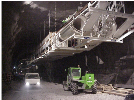
Heck der Vortriebsinstallation mit Luttenspeicher für die Frischluft- und die Sprenggasabsaugung in der Startphase
