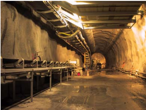
Förderbandanlage mit Hängebühne
