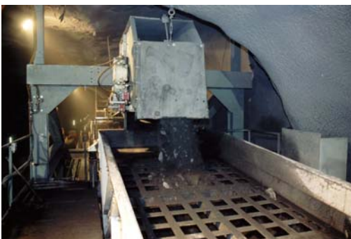
Abwurfstelle Tunnelförderband Süd im Fusspunkt
