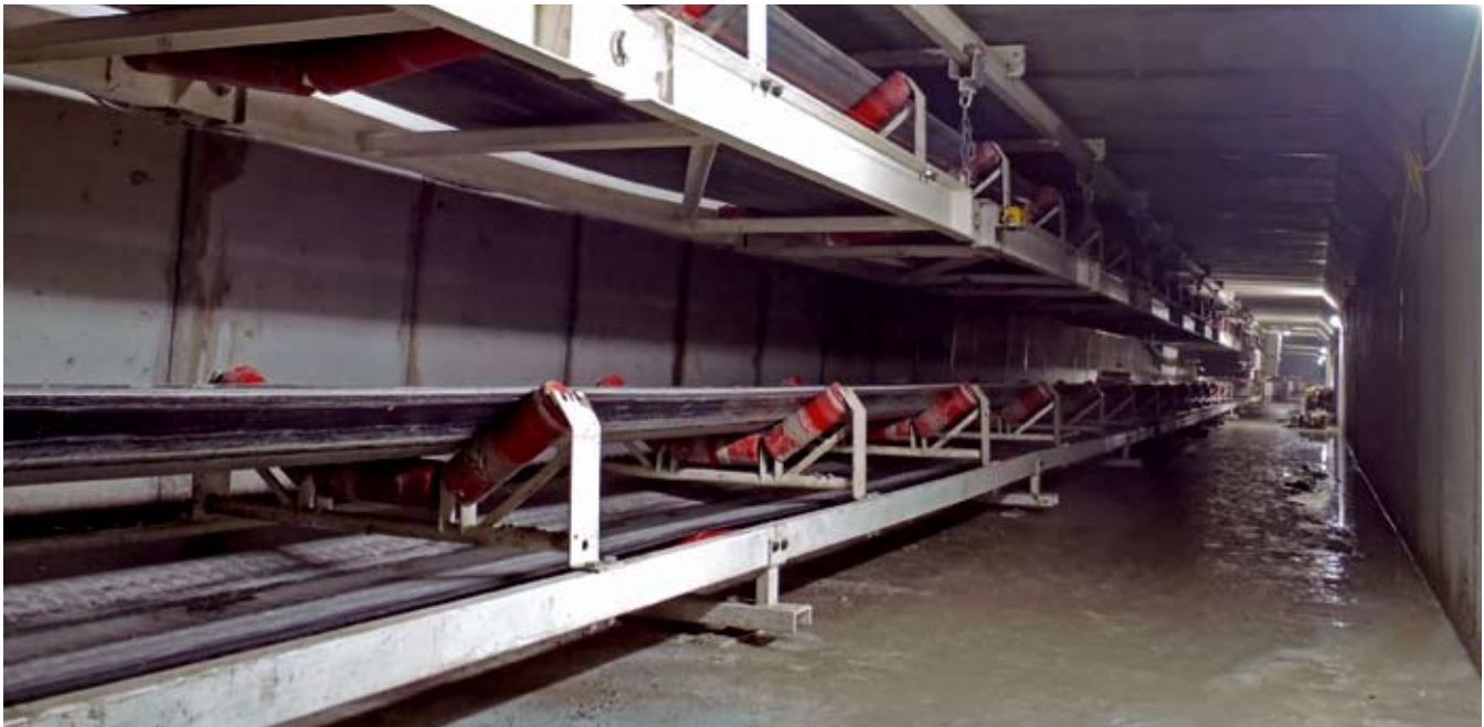
Aufgehängtes Schleppband und Streckenband im Fluchttunnel
