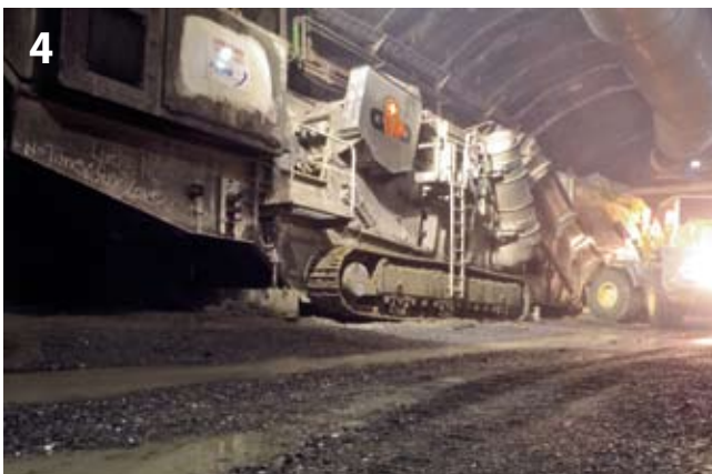
4 Backenbrecher im Bereich des Kalottenvortriebs Jaw crusher in the crown heading area
