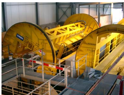
Testlauf und Inbetriebnahme
