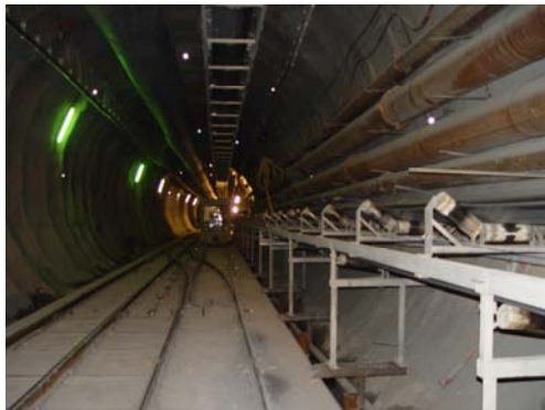
Streckenbandanlage in der EST Süd
