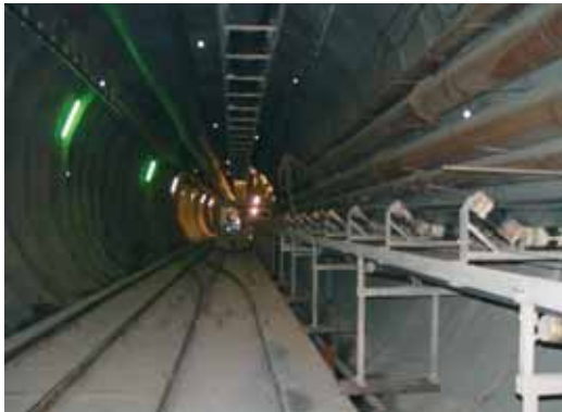
Streckenbandanlage in der EST Süd
