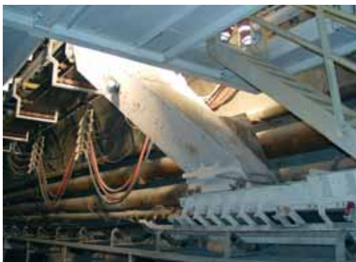
Übergabestelle Schlepband – Streckenband
