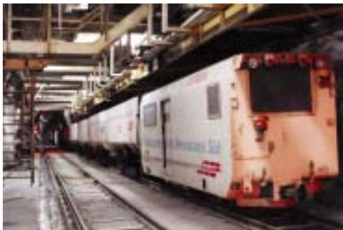
Der Schutterzug wird von der Hängebühne aus beladen. Das zweite Gleis dient als Baustellenversorgung.
