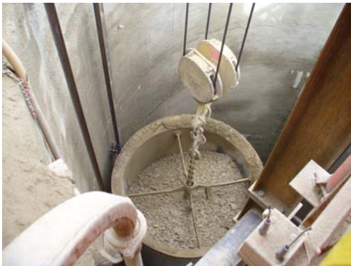
Schachtförderkübel im Aufzug
