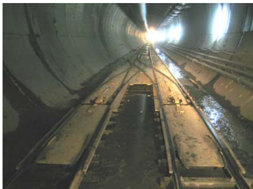
Doppelkreuzungsweiche im Tunnel
