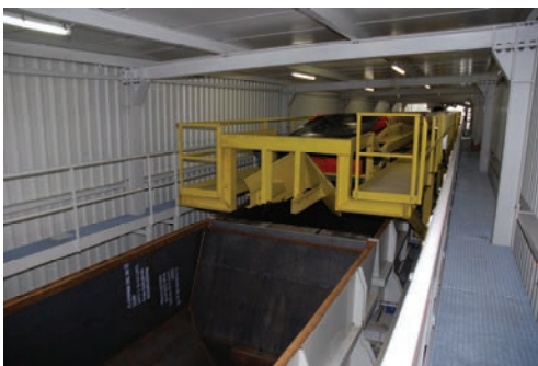
Bahnverladeanlage innen, oben
