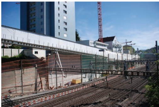
Streckenbandanlage Kies und Ausbruch
