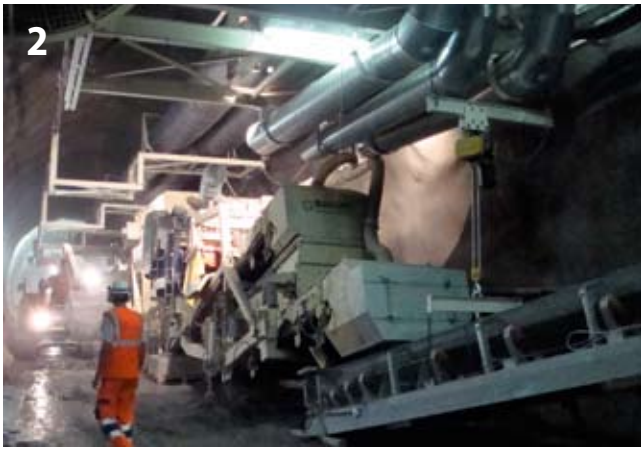
2 Teleskopierbare Ventilationsbühne für die optimale Frischluftzufuhr bis zur Ortsbrust und zur effizienten Spülung der Sprengschwaden
